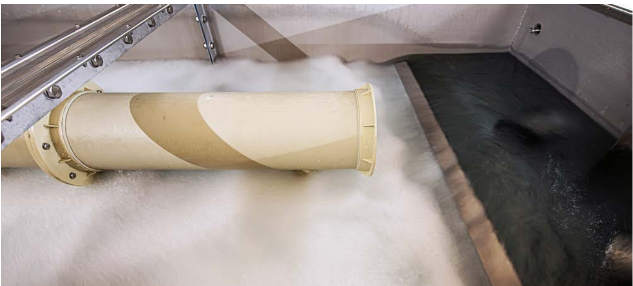
Abbildung 4: Trinkwasseraufbereitung – physikalische Entsäuerung (Quelle: Stadt Groß-Umstadt)
